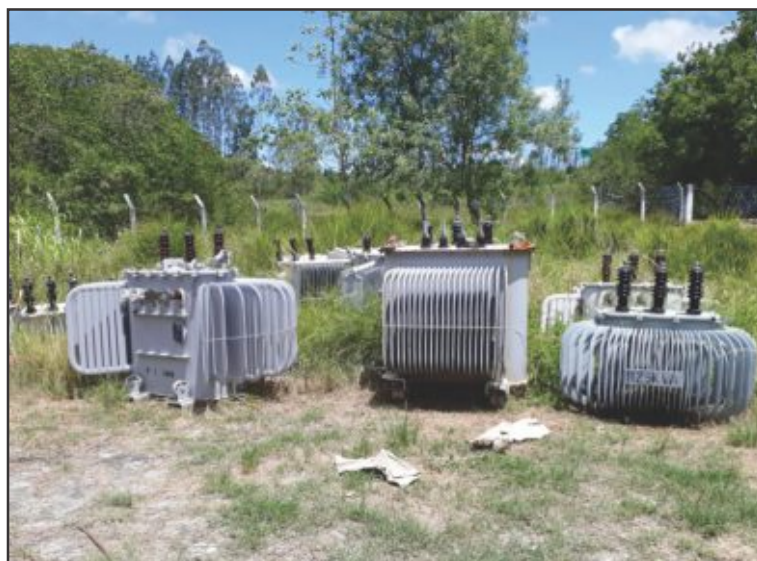
▲ Transformadores caríssimos, abandonados e expostos ao tempo
