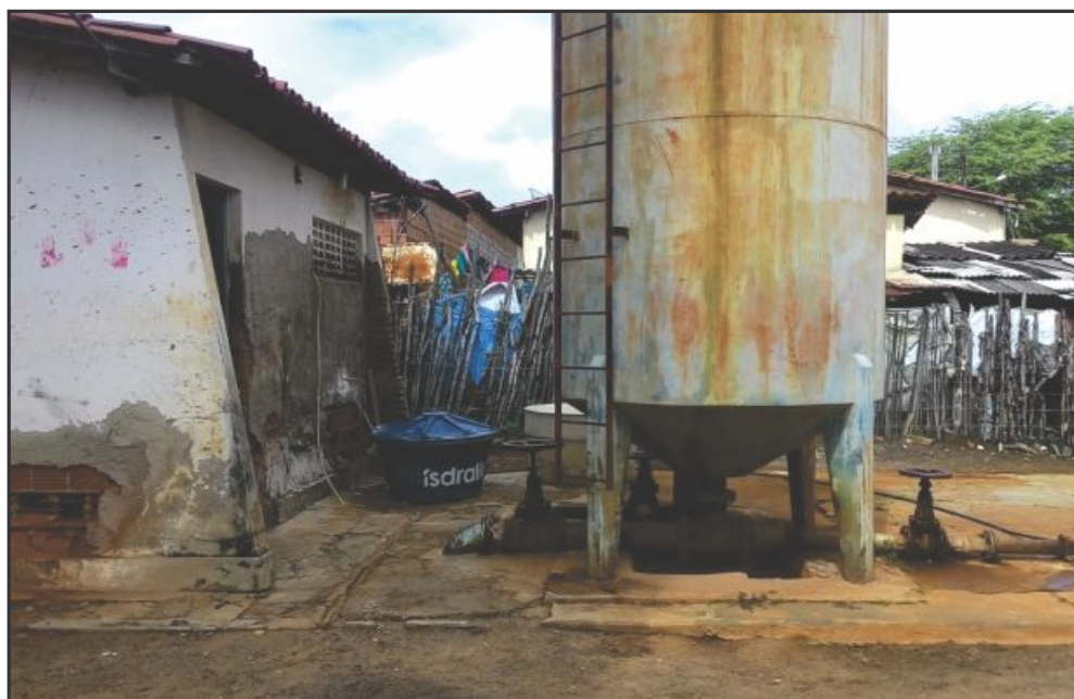
▲ Situação da estrutura física da ETA Brejão dos Negros é precária, como mostra imagem
