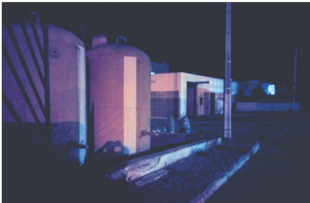
▲ A escuridão tomou conta do complexo da ETA de Canindé, tornando o trabalho perigoso
