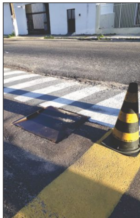
▲ E, bem próximo da entrada, tampa de aço vai afundando sem que ninguém resolva
