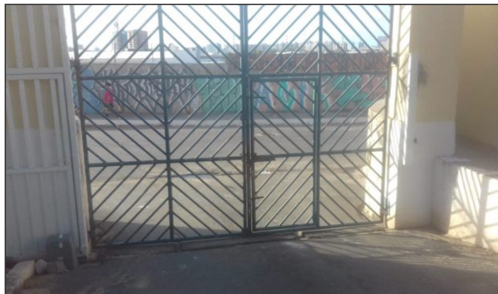
▲ Portão que era para trazer maior sensação de segurança, quebrado, não adianta de nada
