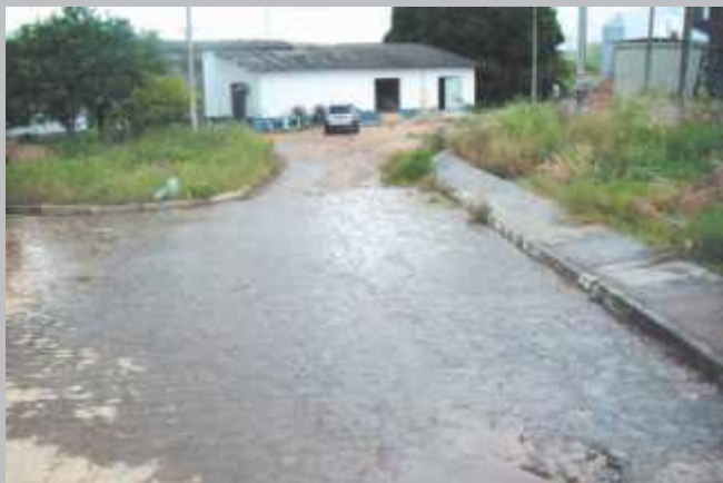
▲ Jorrando: enorme vazamento na ETA de Porto da Folha, que tem prejudicado o tratamento da água na região.
