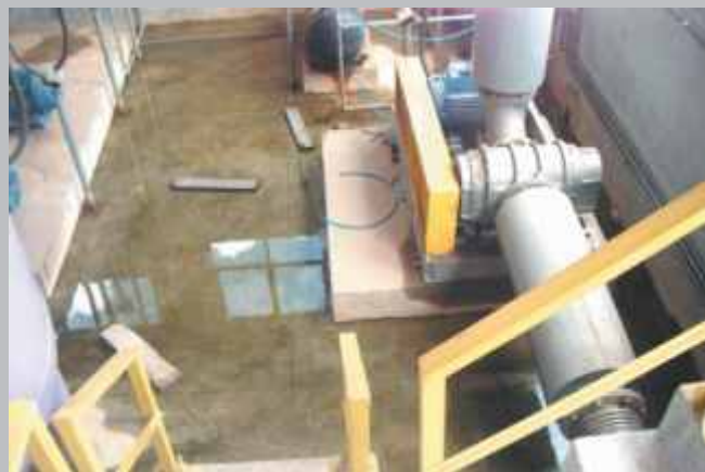
▲ Vazando: mesmo inaugurada há pouco tempo, a EA1 já apresenta problemas, como vazamento nas bombas.
