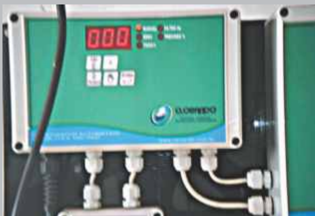
▲ Clorador: na foto, o clorador aparece ZERADO, o que mostra que a água não recebeu o tratamento com cloro.
