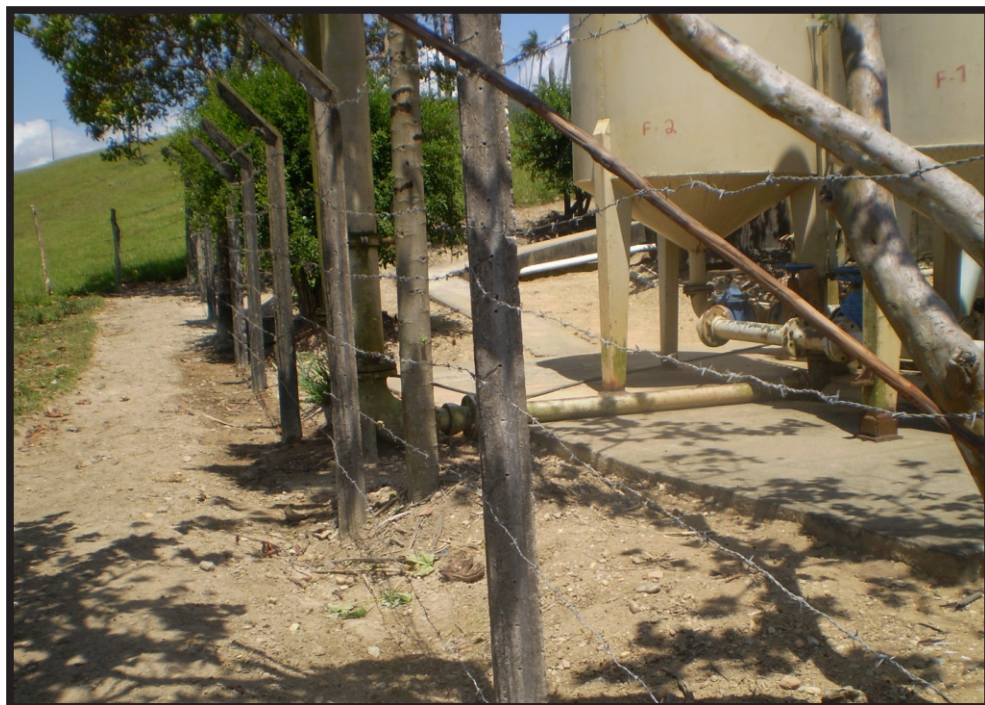
▲ Foto da ETA de Indiaroba, tirada antes do início da obra: situação continua sem solução
