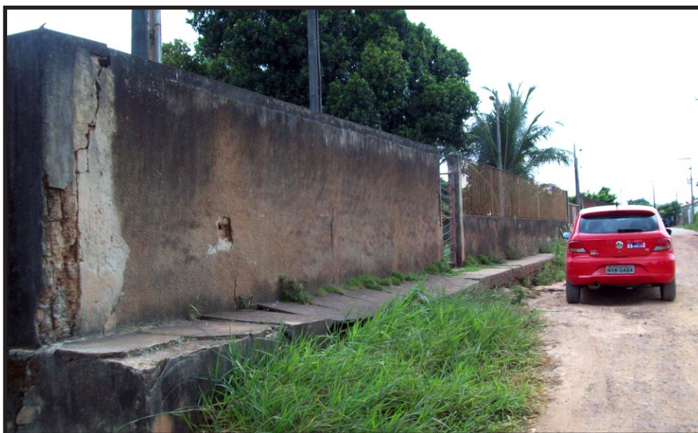
| ETA Cristinápolis: muros rachados, mato tomando conta e paredes da unidade caindo
