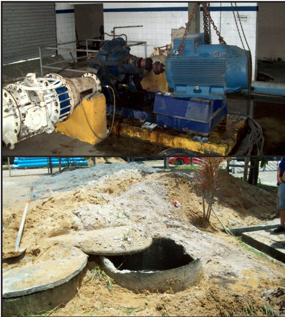
FLAGRANTES: bombas abertas e largadas; fossa aberta e exalando mau cheiro
