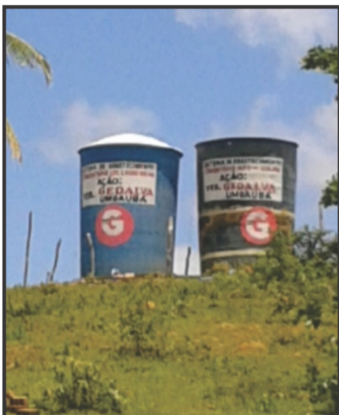
▲ Perfuração, encaenação e reservatórios instalados sem participação do SAAE
