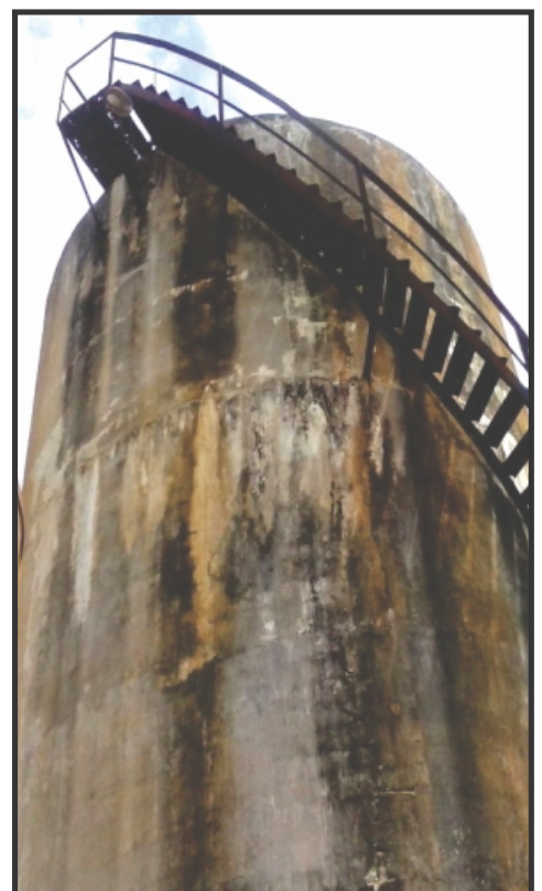
▲ Risco: escadaria de acesso ao reservatório elevado está totalmente corroída
