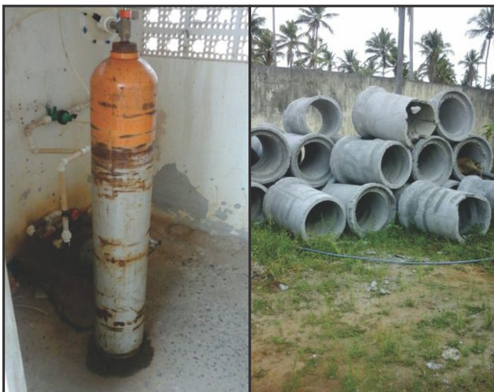
▲ IRREGULARIDADES | Cilindro de cloro gasoso operando de forma precária, colocando em risco a vida do operador; e manilhas que ninguém sabe a quem pertence
