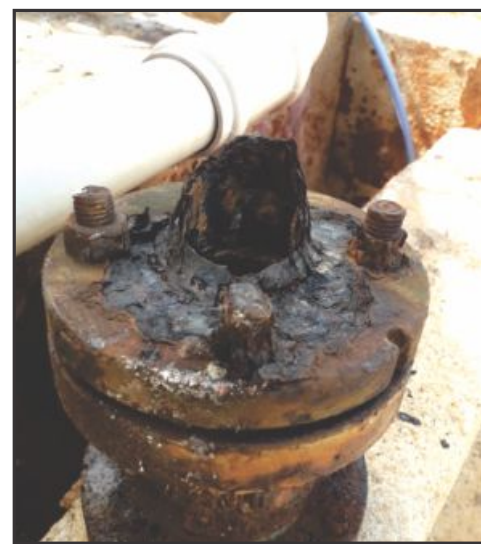
▲ Flange metálico que se desprendeu por causa da corrosão e quase causa um acidente fatal
