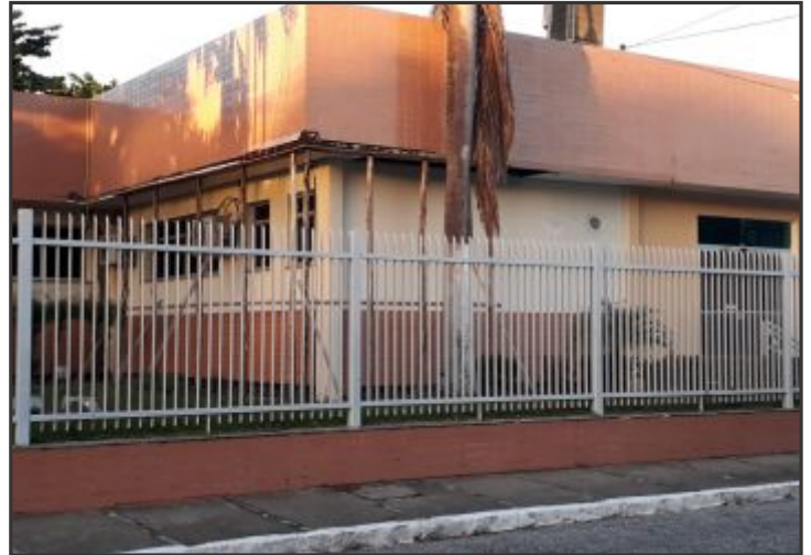
▲ Escoras de madeira há meses denunciam a inércia na reforma da sede
