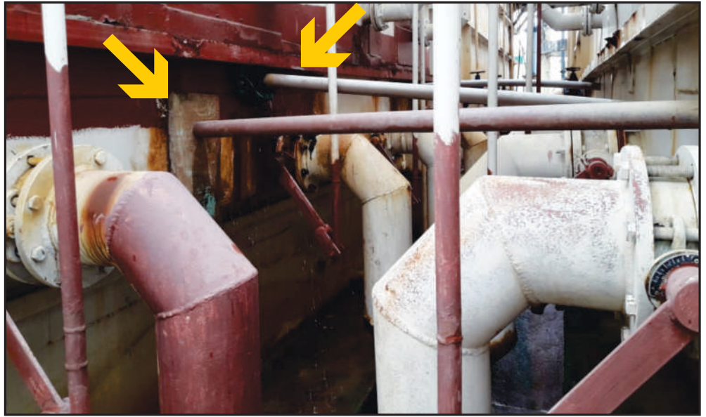
▲ Decantadores recém-reformados e já apresentam vazamentos, contidos por escoras
