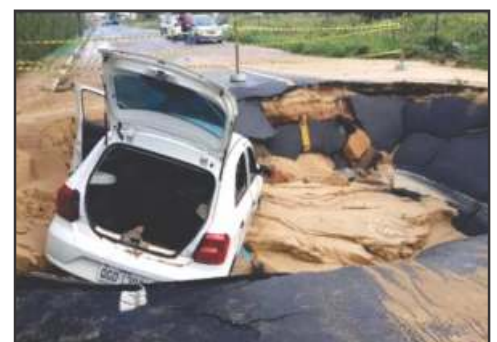
▲ Com o rompimento da tubulação de fibra de vidro, estrada cedeu e carro acabou engolido
