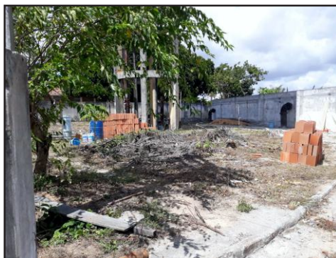
▲ Elevatória e reservatório de Itabaianinha
